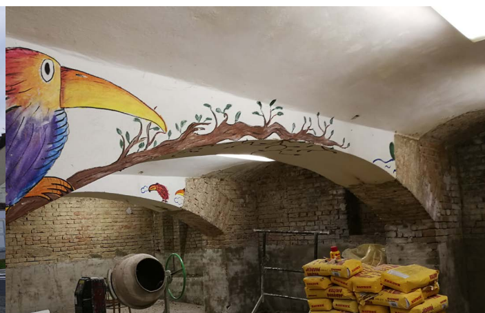
ZŠ náměstí Republiky - sanace vlhkosti
